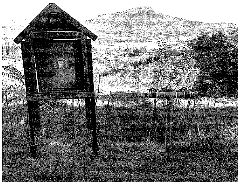
Εικόνα 6: Κρουνός πυρόσβεσης διπλής κεφαλής και πυροσβεστική φωλιά στο Αισθητικό δάσος του Δ. Φαρσάλων.
